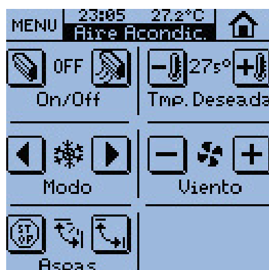
Pantalla de Clima preparada para Aire Acondicionado.
